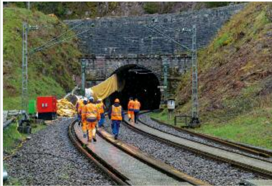
Ein Bautrupps der Firma Sachtleben begibt sich am 6. Mai 2021 in den Sommerautunnel zur Schadensaufnahme. Links im Bild ist bereits das Tunnelentlüftungssystem für die anstehenden Bauarbeiten zu erkennen.
